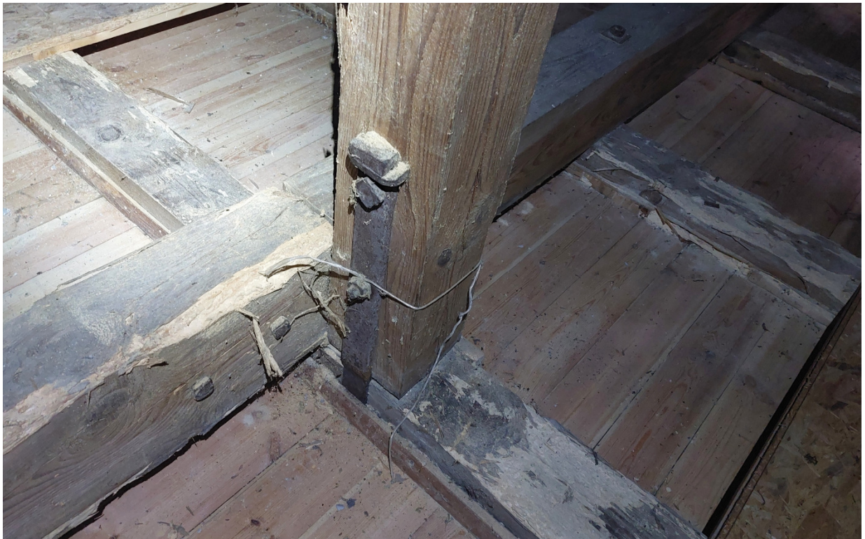
Zdj. 11. Korozja biologiczna od owadów – uszkodzone belki stropowe i płatów.
