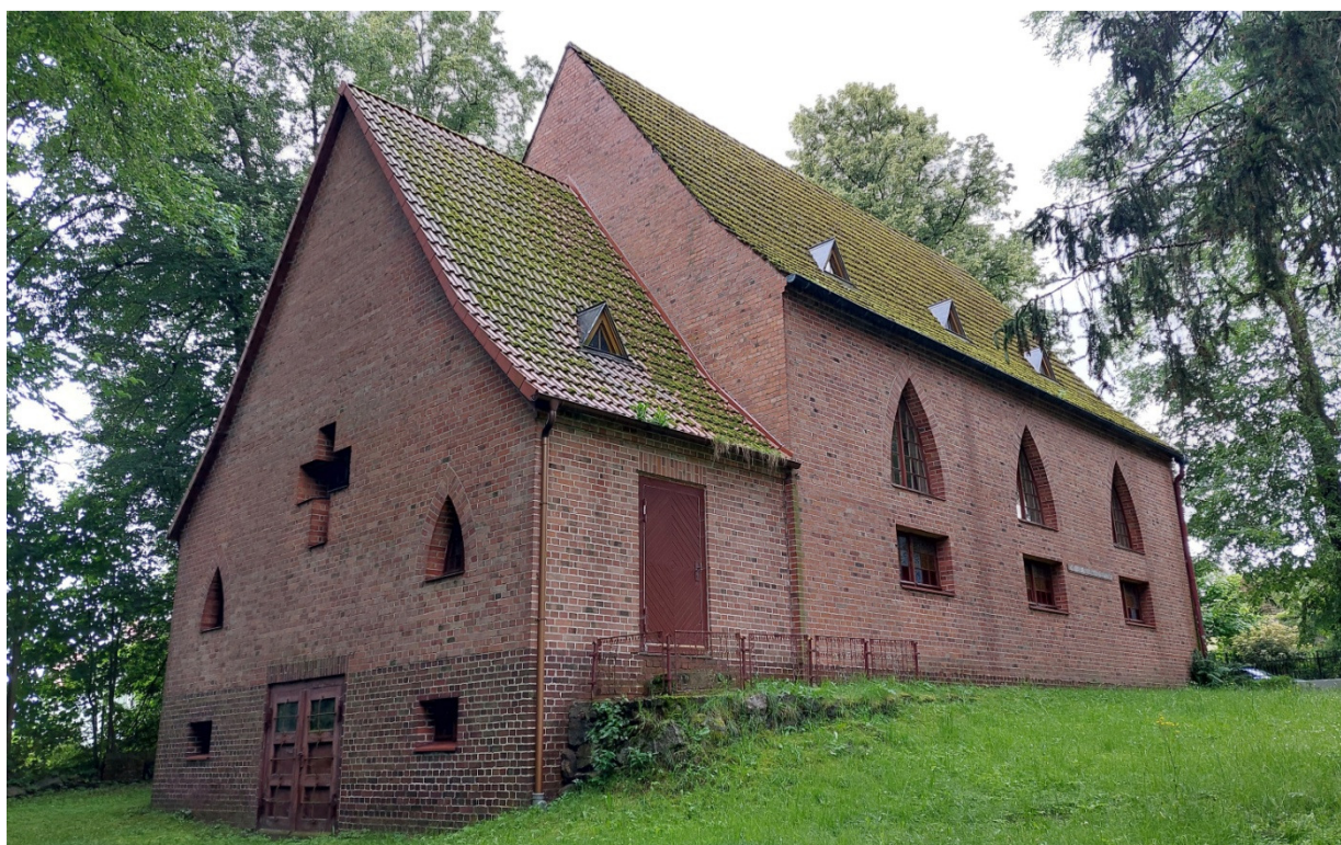
Zdj. 2. Elewacja północna i wschodnia. Rozwój mchów na połaciach oraz traw w rynnie, a także zacieki od nieszczelnych rynien i rur spustowych.
