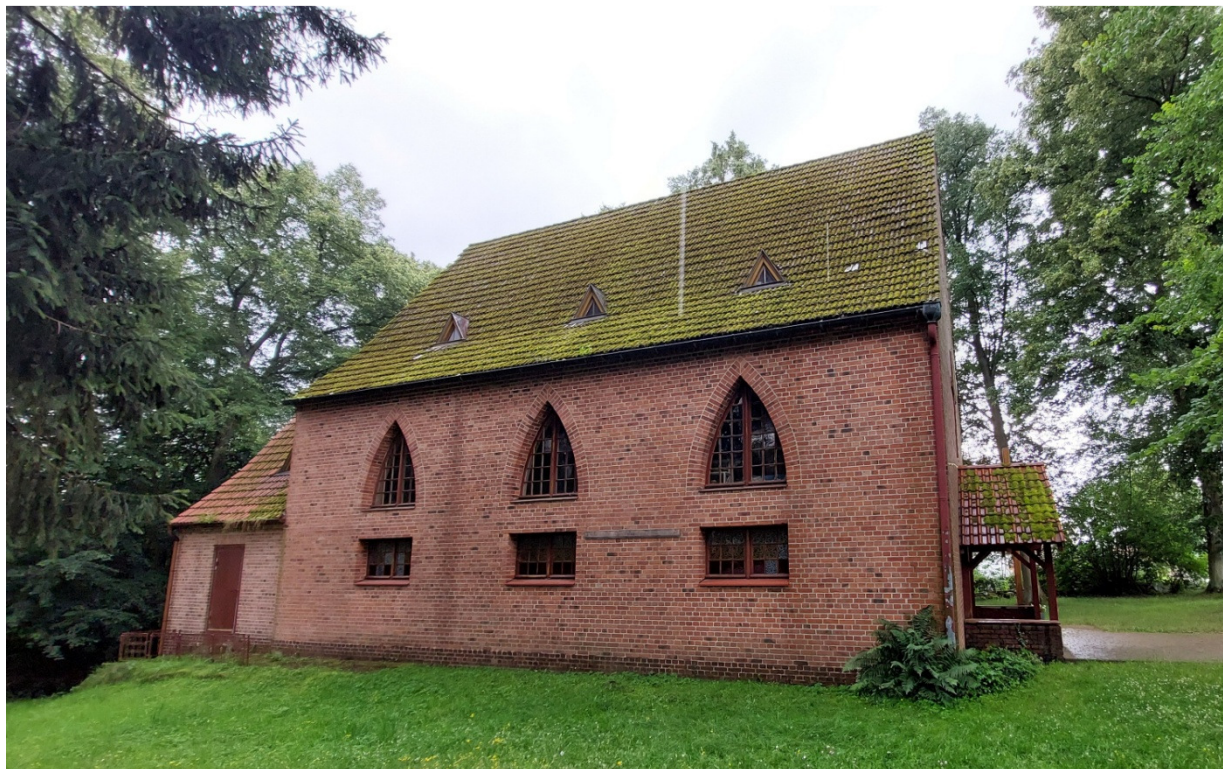
Zdj. 1. Elewacja północna. Rozwój mchów na połaciach oraz zacieki na elewacji.
