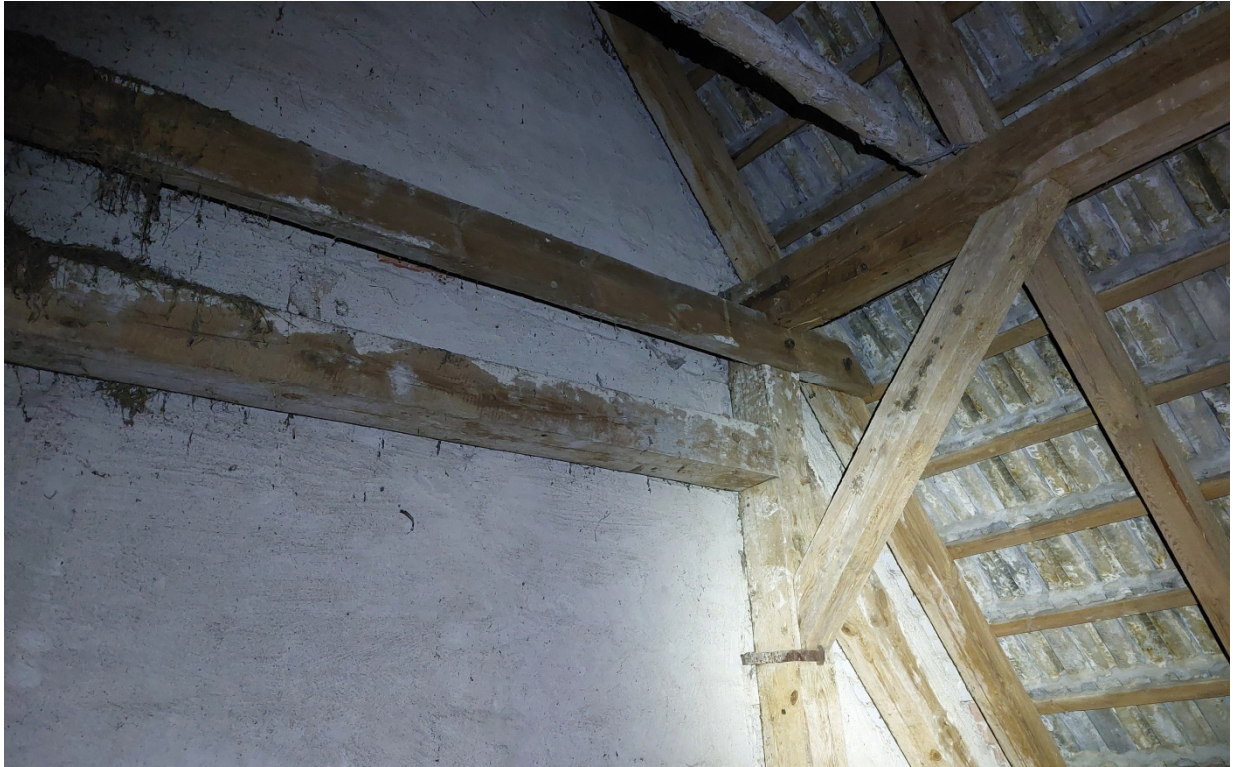
Zdj. 7. Białe wykwity solne w obrębie ściany szczytowej, które powstały na skutek wód opadowych z nieszczelności połaci dachowej.
