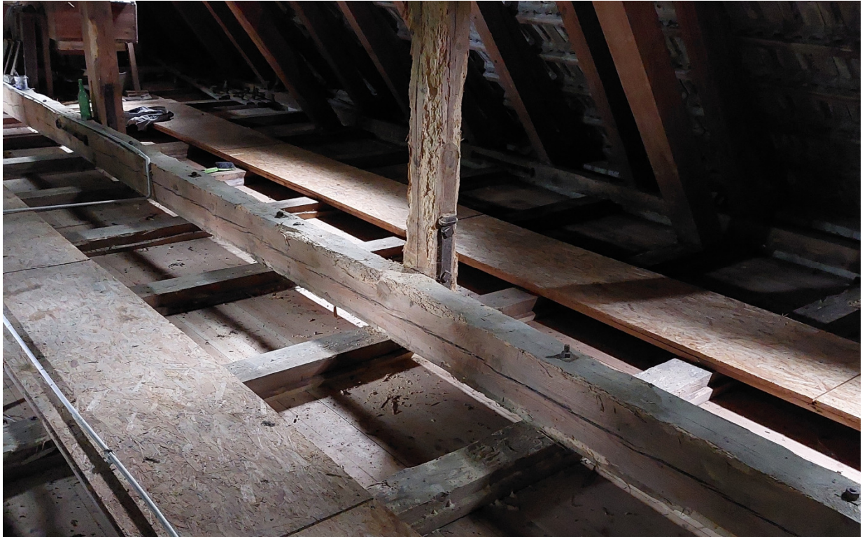
Zdj. 9. Widok ogólny na strop nad nawą. Widoczny skorodowany przez szkodniki stolec, płatów dolna i odkryte belki stropowe (również skorodowane) oraz wtórne pokrycie wierzchnie z płyt OSB-3 z ułożoną instalacją elektryczną.
