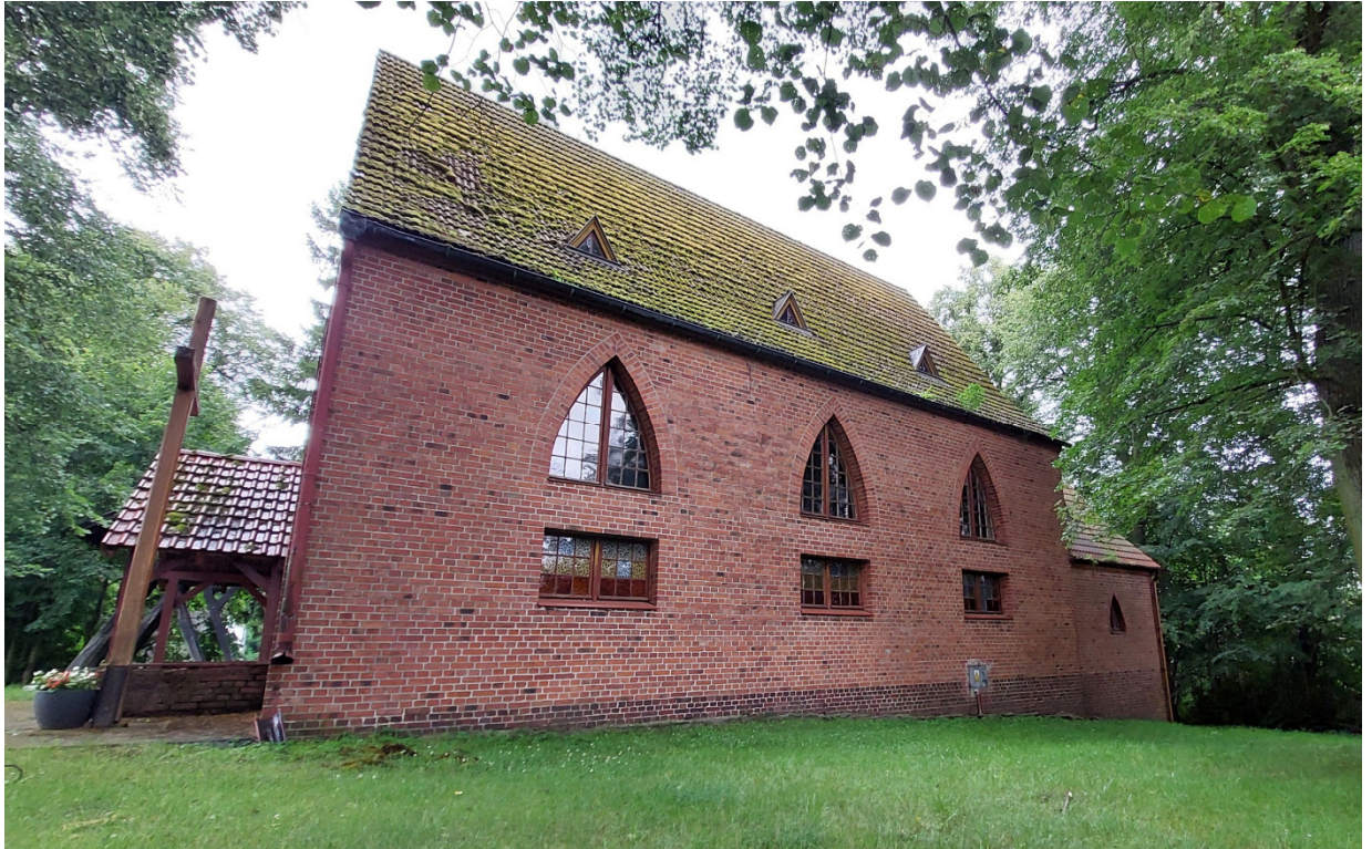
Zdj. 3. Elewacja południowa. Rozwój mchów na połaciach oraz traw w rynnie nawy, a także skorodowana i zbyt krótka rura spustowa.
