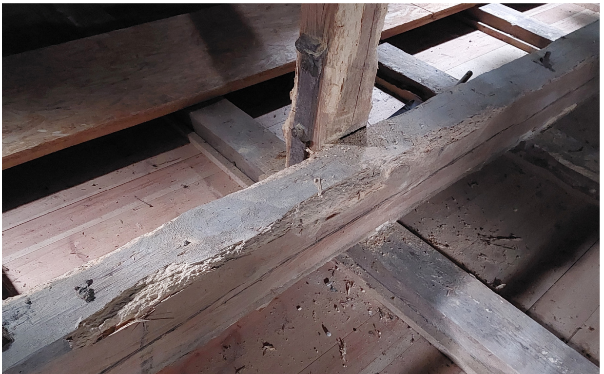
Zdj. 10. Ubytki w przekroju płatwi dolnej i stolca.
