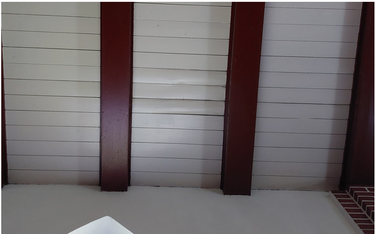
Zdj. 14. Zdegradowane deski pułapu dolnego widoczne od spodu.
