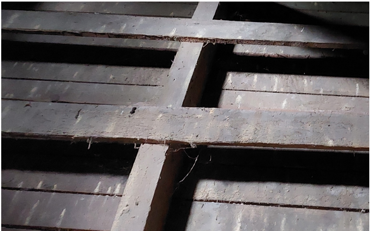
Zdj. 18. Zbliżenie na konstrukcję stropu ostrołukowego. Występują otwory wylotowe owadów żerujących w drewnie oraz mączka drzewna.
