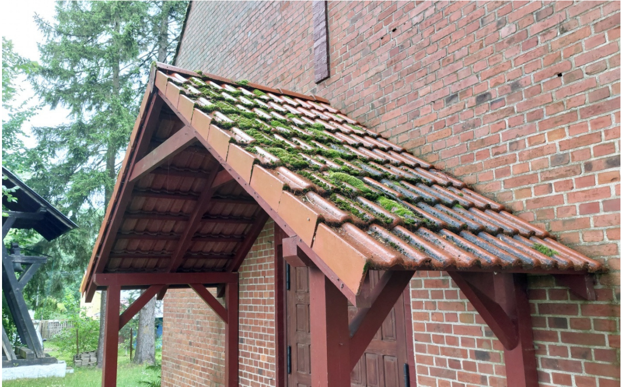
Zdj. 5. Wtórne zadaszanie nad wejściem głównym dostawione do zachodniej elewacji budynku. Dachówka zabrudzona, porośnięta mchem.
