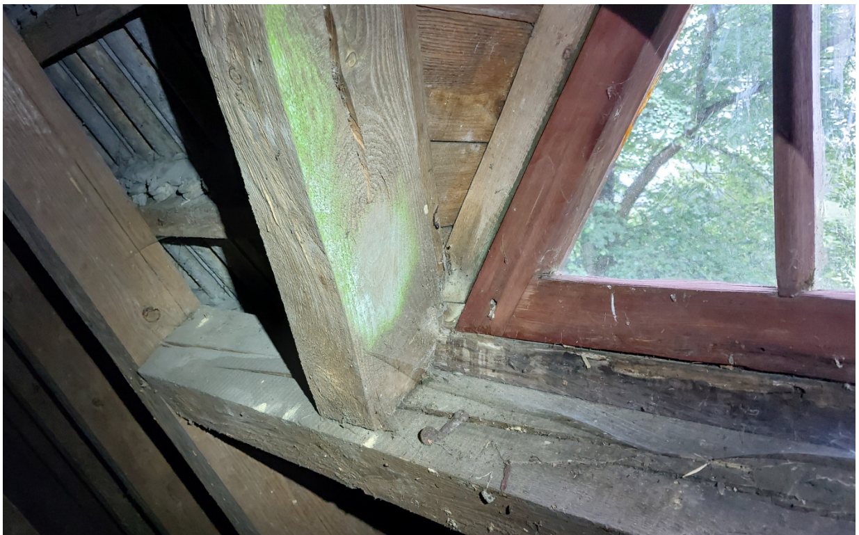
Zdj. 12. Widoczny fragment konstrukcji dachu z lukarną i oknem krosnowym. Wymiany i krokwie rozeschnięte, ze wzdłużnymi pęknięciami.
