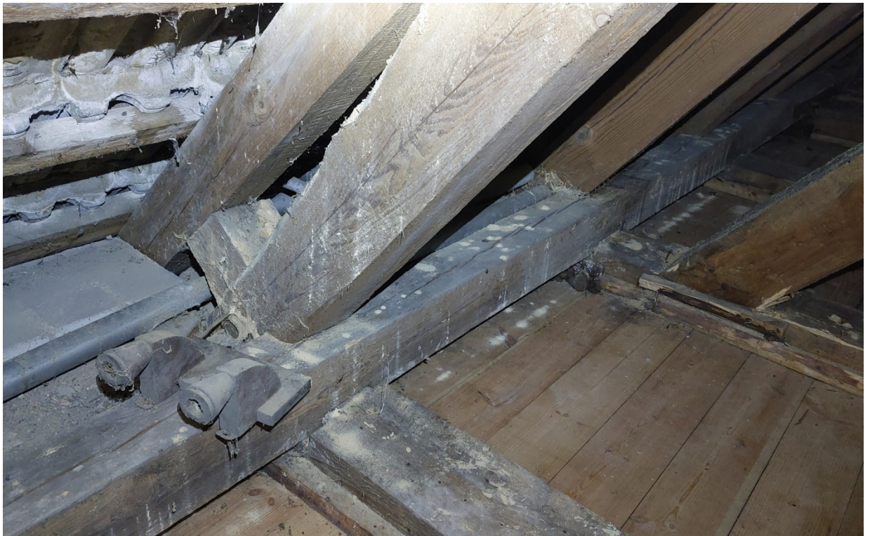
Zdj. 8. Widoczny odslonięty dolny pułap stropu belkowego oraz obficie występujące kopczyki mączki drzewnej powstałe na skutek żerowania szkodników drewna.
