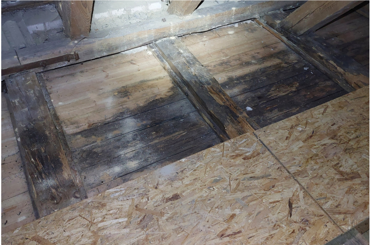
Zdj. 13. Korozja biologiczna belek stropowych i desek pułapu dolnego, powstała na skutek długotrwałego zalewania tej części stropu od nieszczelnej połaci dachowej.
