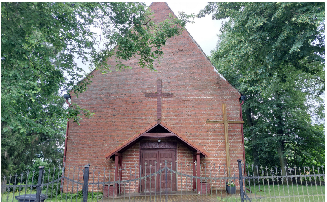
Zdj. 4. Elewacja zachodnia. Widoczne nieestetyczne uszczelnienia miejsca styku ściany szczytowej z dachówką.
