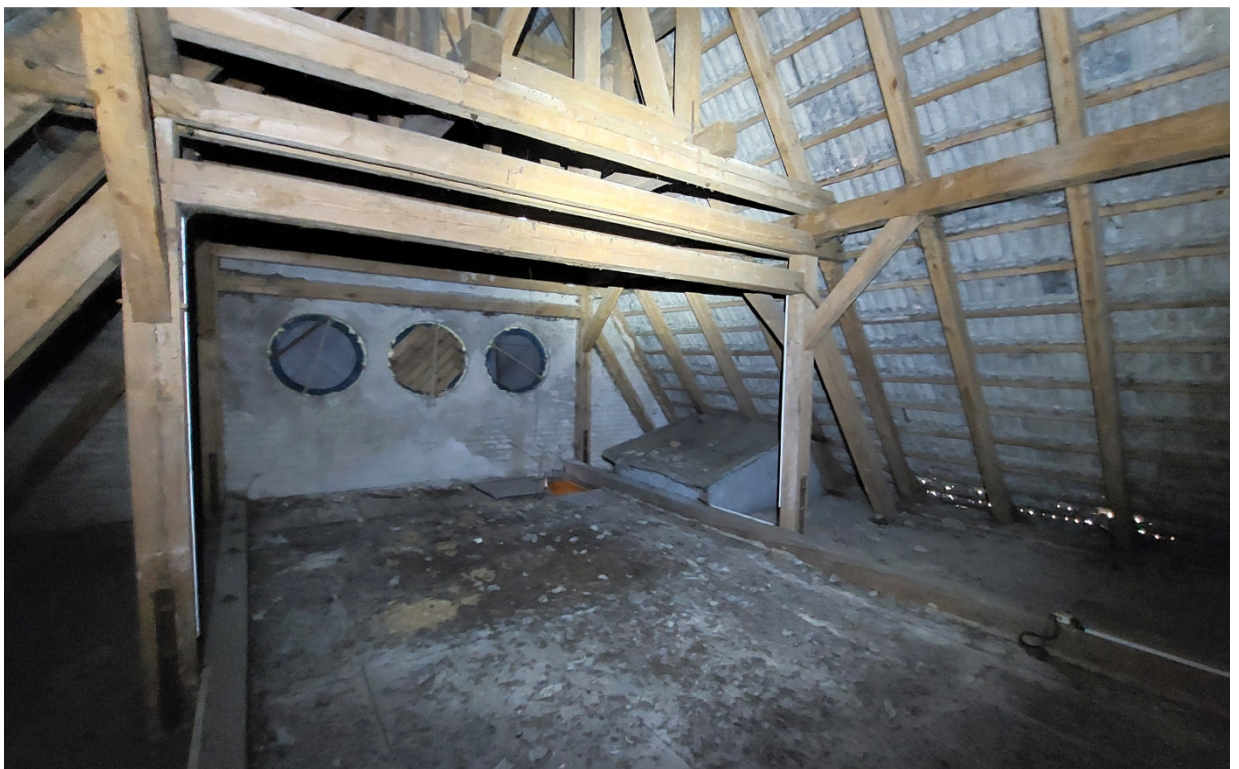
Zdj. 8. Widok ogólny na więźbę w miejscu podparcia konstrukcji wieżyczki. Poniżej podłoga w ciemniejszym odcieniu – zmiany od nieszczelności połączenia wieżyczki. Z prawej strony otwory najniższych rzędach dachówki.
