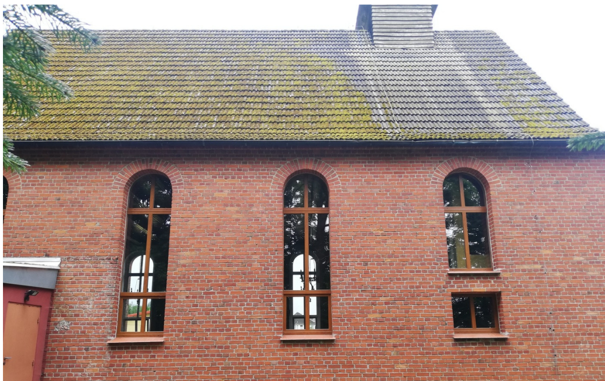
Zdj. 2. Rozwój mchów na połaci północnej oraz osad od przekrycia z blachy miedzianej.
