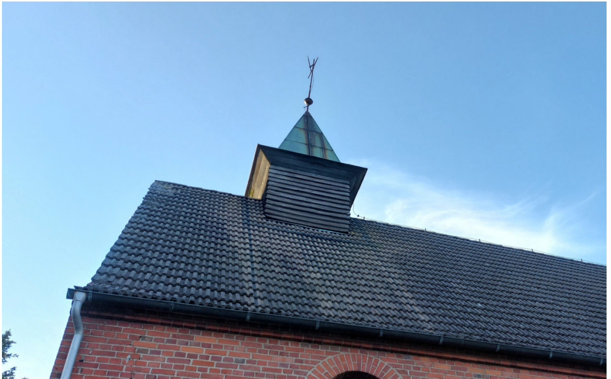
Zdj. 3. Korozja blachy miedzianej oraz osad przekrycia osadzający się na dachówce.
