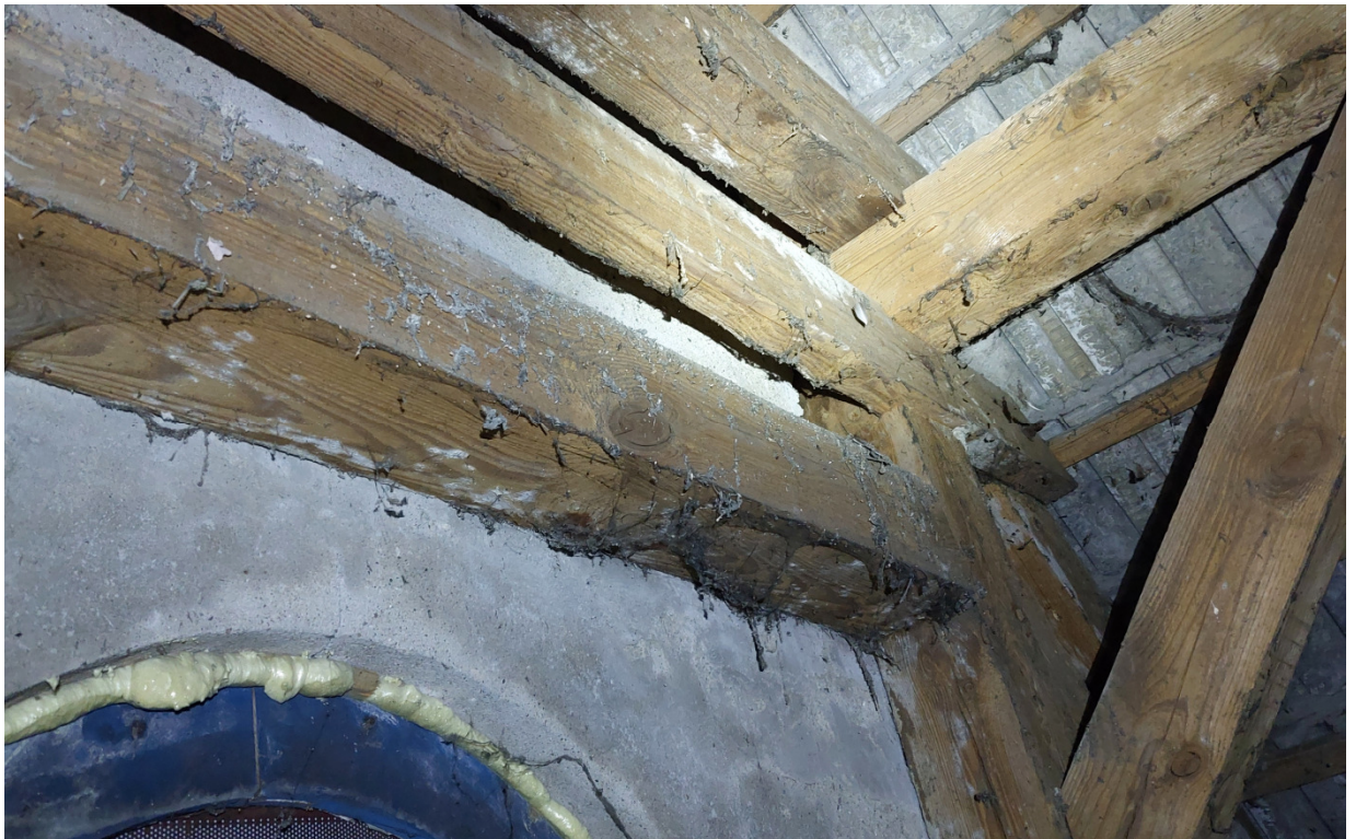
Zdj. 11. Elementy drewniane przy obu szczytach w gorszym stanie z uwagi na dawniejsze nieszczelności w miejscu łączenia dachówki z wierzchem ściany szczytowej.
