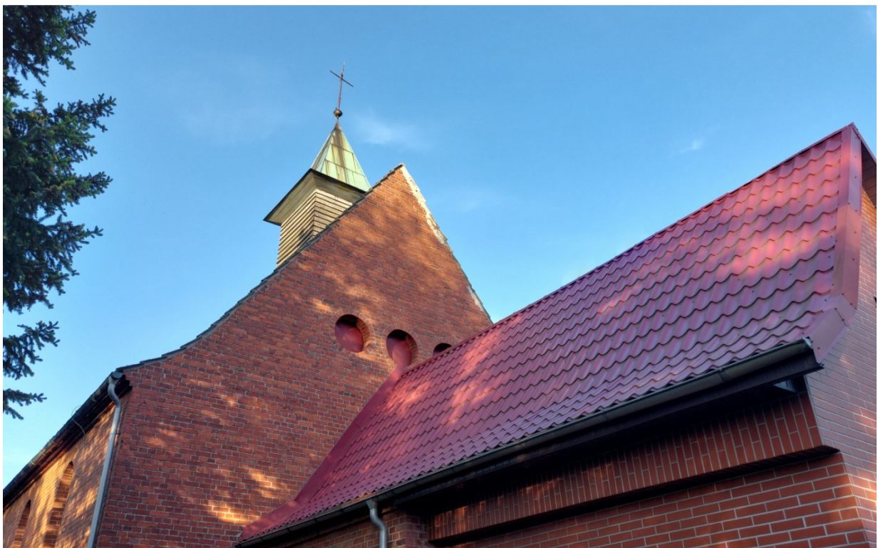
Zdj. 4. Połączenie nad kruchtą kryte współczesną blachodachówką. Szczyt nawy uszczelniony zaprawą cementową, wieżyczka skorodowana, krzyż odchylony od pionu.
