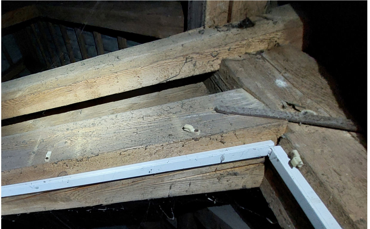
Zdj. 10. Stan elementów drewnianych. Widoczne miejsce prowadzenia instalacji elektrycznej.
