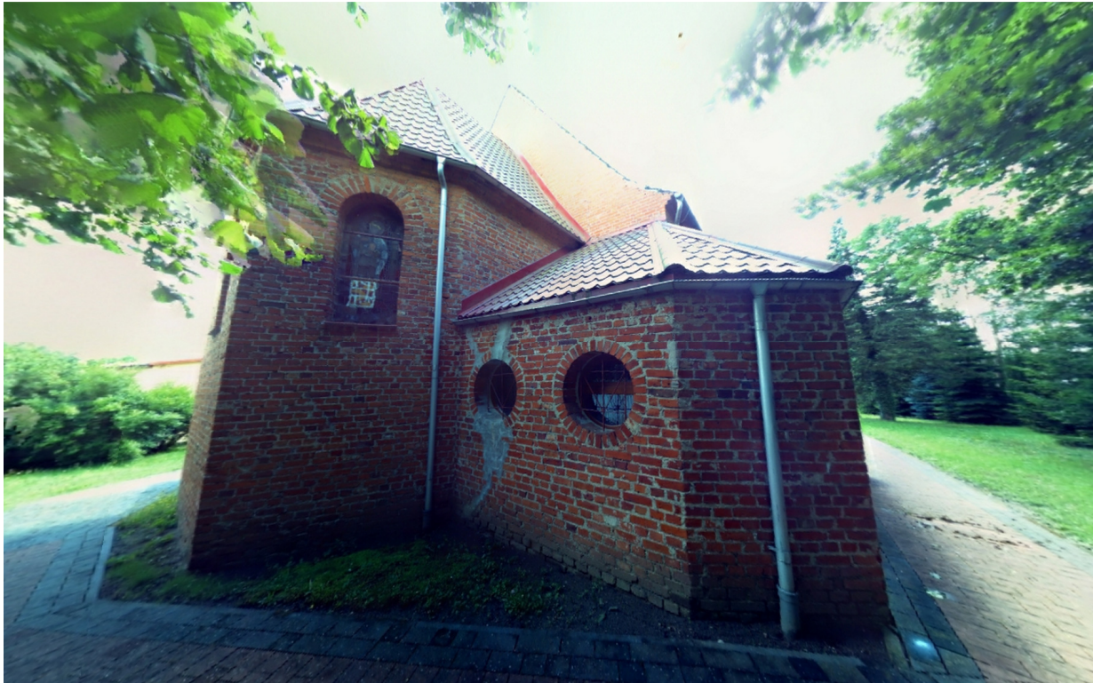
Zdj. 5. Widok od strony północno-zachodniej. Połacie kryte blachodachówką. Występują ubytki i próby napraw spoin i pęknięć w obrębie okna.
